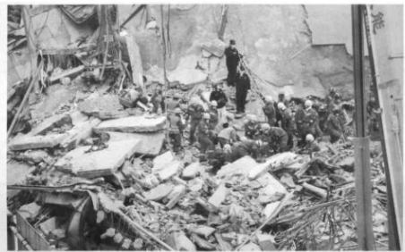
福建泉州酒店坍塌10死 为新冠肺炎医学观察点
